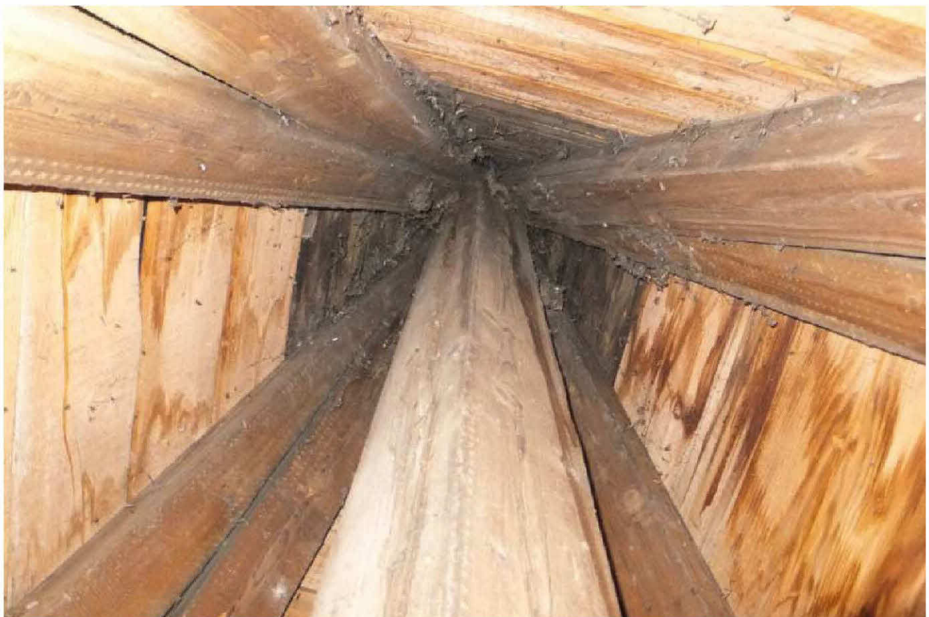
Kirchturm: Feuchteschäden Übergang Kaiserstiel-Turmkreuz
