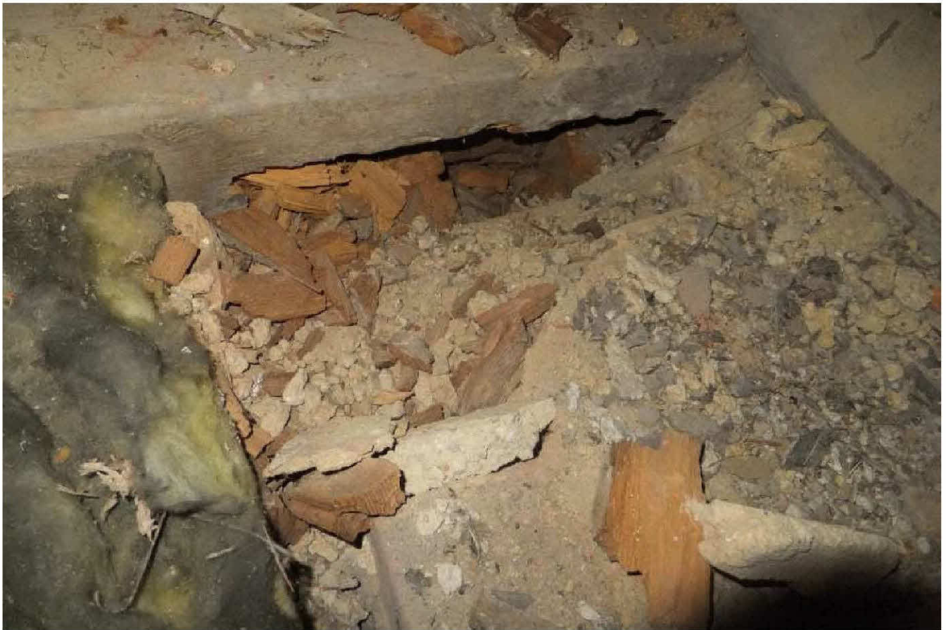
Kirchenschiff: Verfauter Zerrbalken mit Schwammbefall
