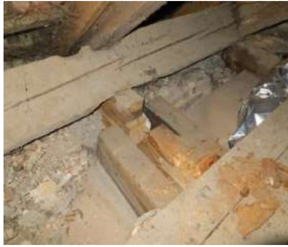
Der Dachstuhl des Kirchenschiffs ist an vielen Stellen morsch.
